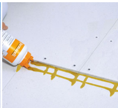
Bild 4: Klebeschnur an der Plattenkante der zweiten Lage FERMACELL. Verklebung der oberen Stoßfuge durch Auftrag der Klebeschnur max. 10 mm vom Rand (erfolgt automatisch durch die Führung der Kleberflasche an der Plattenkante)
